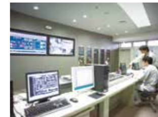
設備集中監視
