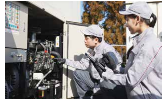
非常用発電設備点検
