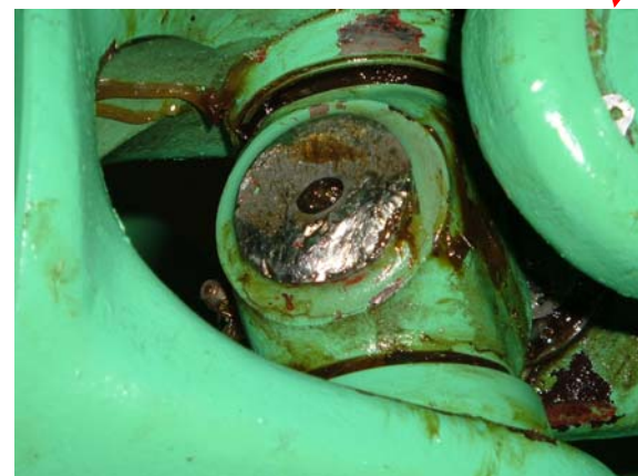
ユニバーサルジョイント（北側）
