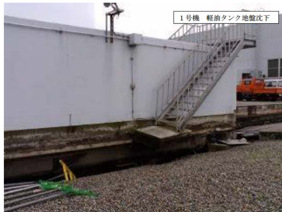
軽油タンク周辺地盤の沈下
