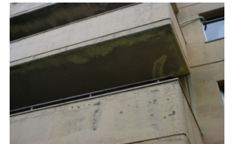
老朽化した外壁
