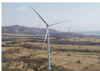
リエネ松前風力発電所
