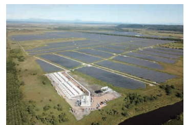
すずらん釧路町太陽光発電所
